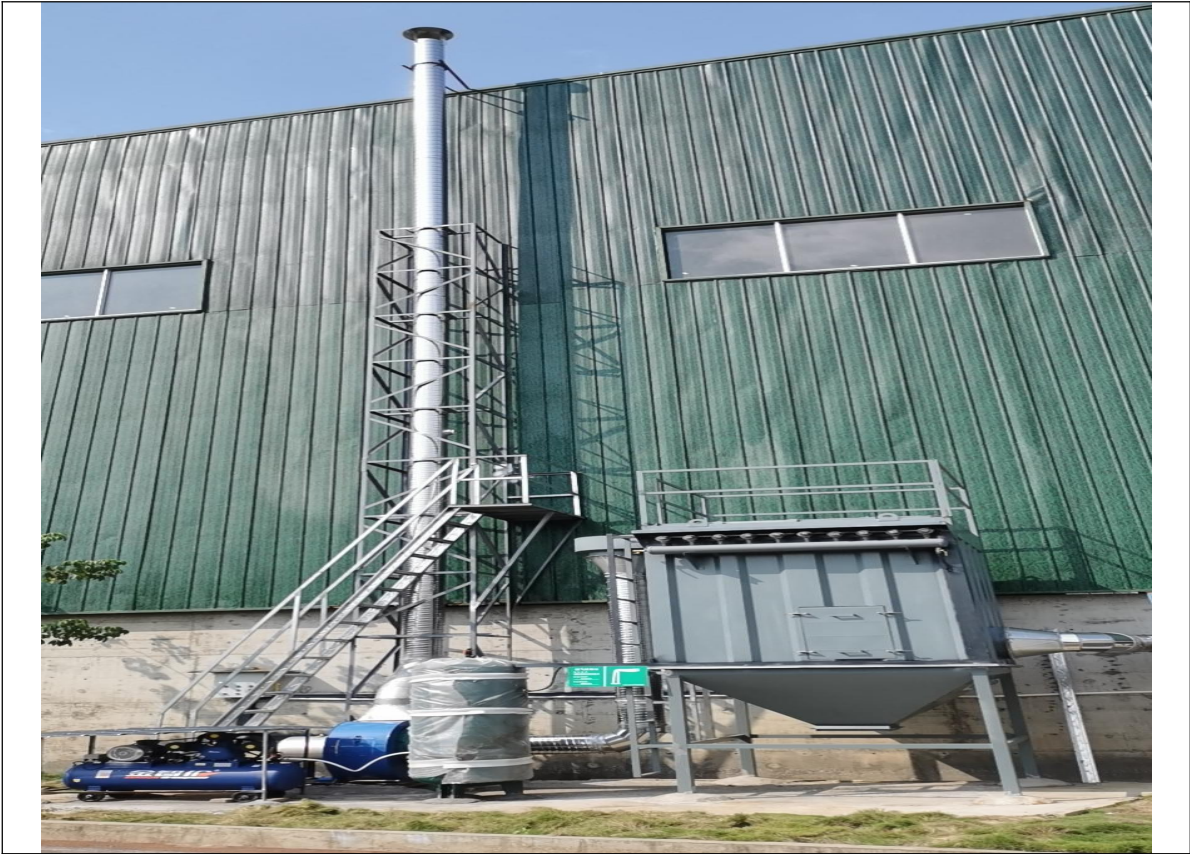
废气处理设施
