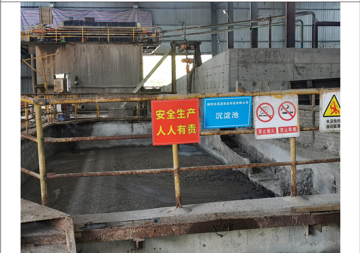
生产废水沉淀池
